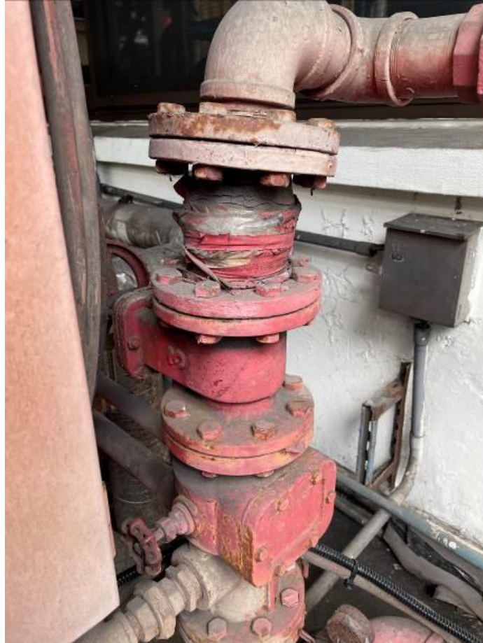
管線鏽蝕漏水
