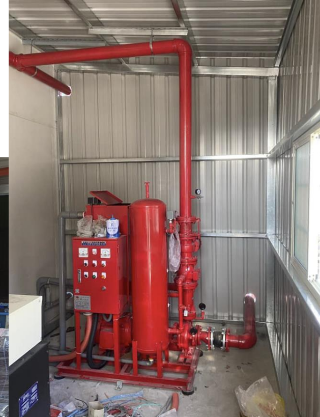
室內消防栓水源設備
