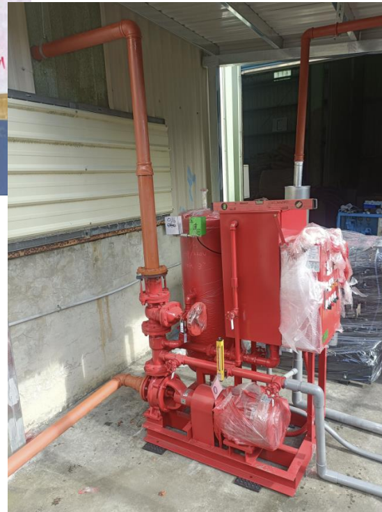
室內消防栓水源設備
