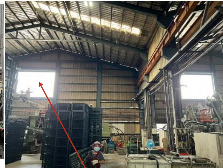
自然排煙捲門-開
