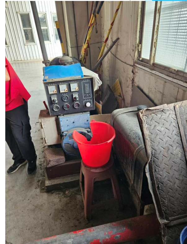
老舊發電機設備
