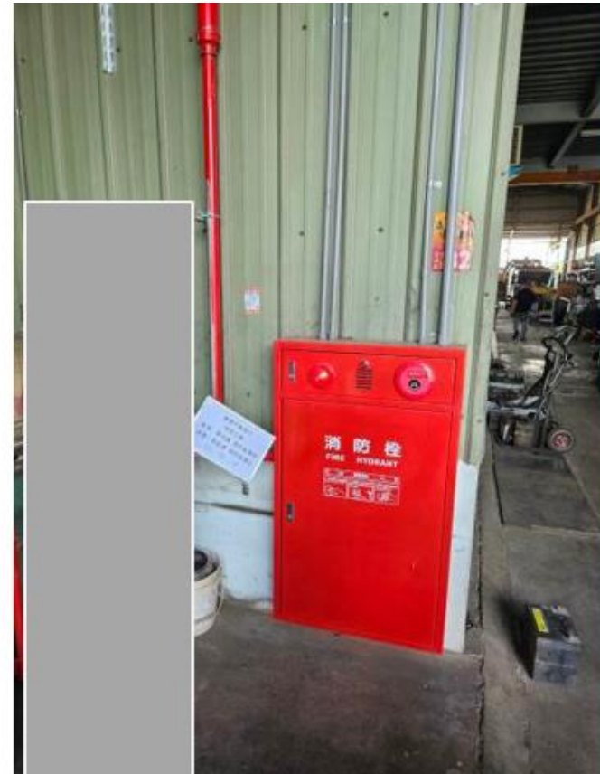
新設室內消防栓設備
