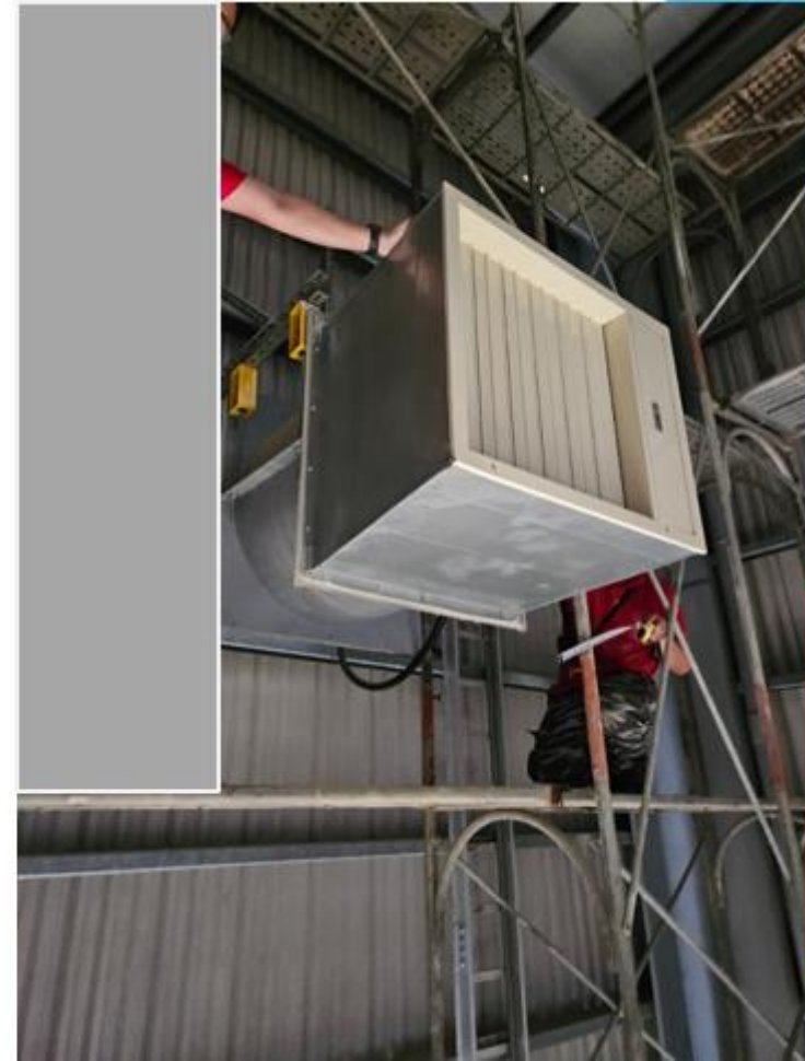
機械排煙閘門
