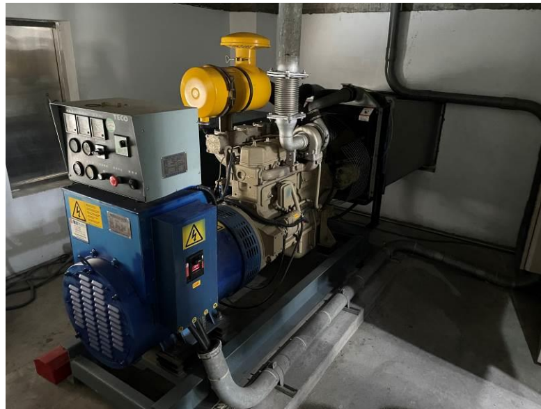
發電機設備外觀
