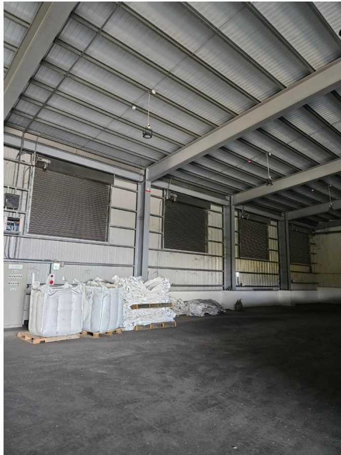
排煙鐵捲門（關）
