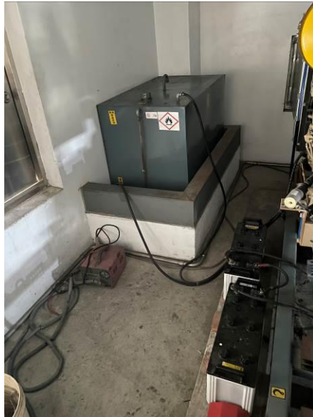
儲油槽 及防溢堤
