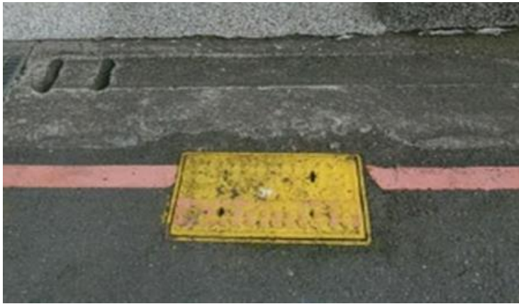
消防栓水源外觀
