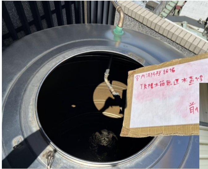
室內消防栓水源設備
