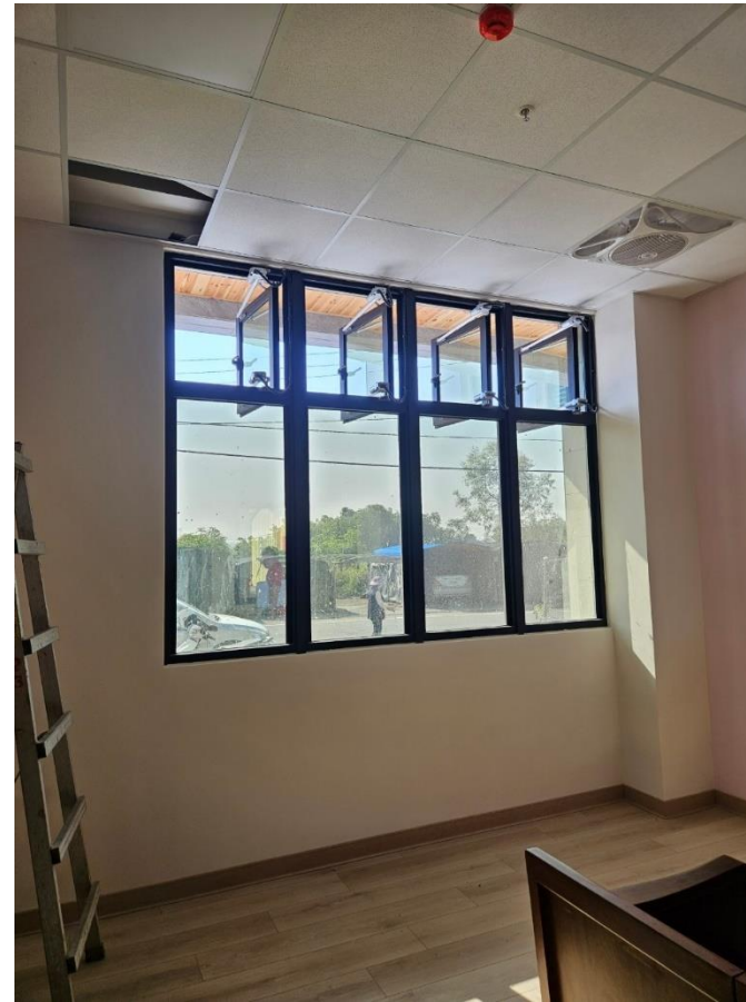
自然排煙窗(電動推桿式)
